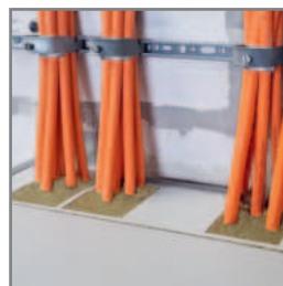
■ Kabeleinführung oben + unten
